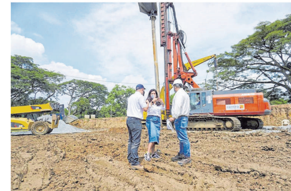
La gerente del Fondo Adaptación, Raquel Garavito, en uno de los recorridos de la obra a lo largo de los 26,1 kilómetros del jarillón para ser reforzado. FOTO: FONDO ADAPTACIÓN
