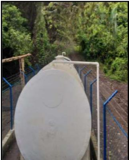
Tanque de almacenamiento
