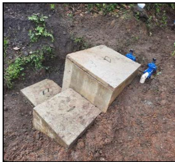
Tanque de quiebre de presión
