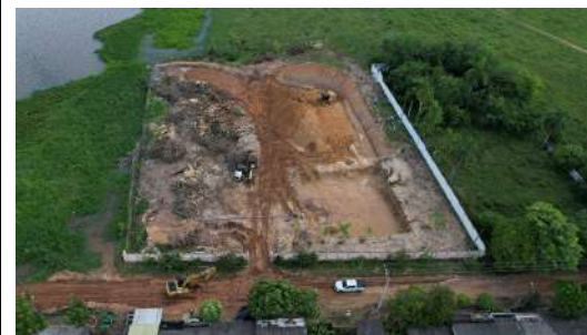
Imagen; 3 Pondaje No. 2 frente No 6B-Municipio de San Marcos
