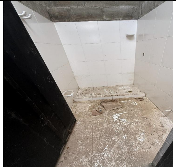
Estado interior del baño
