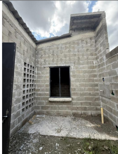
Vista interior de la vivienda- Lavadero, no se instalado el tanque elevado
